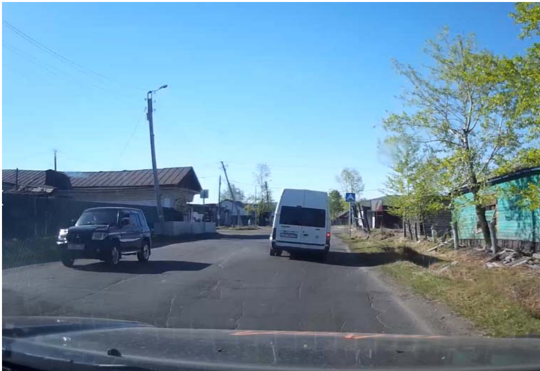
Рисунок 3.4 – Наличие трещин дорожного покрытия на ул. Кирова
