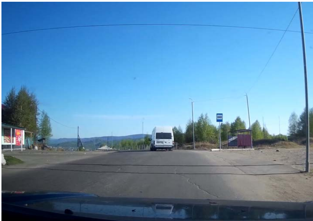
Рисунок 3.5 – Наличие трещин дорожного покрытия на Зеленой ул.
